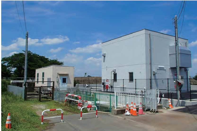
凶川排水機場
