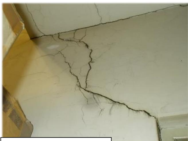
参考写真①（内壁ひび割れ）
