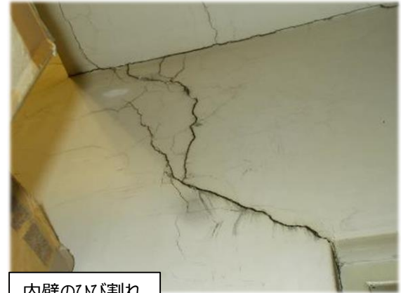
内壁のひび割れ
