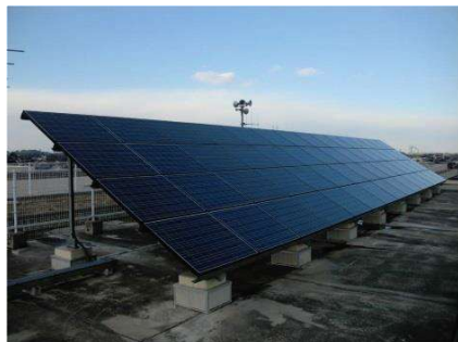
つるせ台小学校の太陽光パネル
