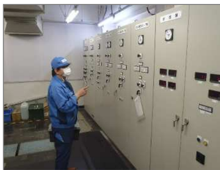
設備の巡回点検
