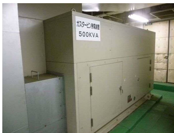
【非常用自家発電設備（水谷浄水場）】
