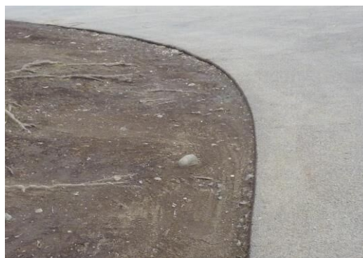
図90 雨水による盛土の流出
