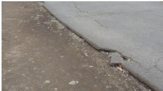
図 113 園路の段差と損傷（学習広場付近）
