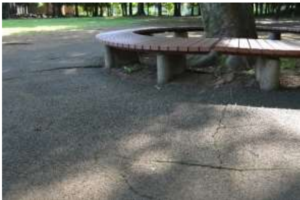
第 76 図 根上りにより破損した園路
