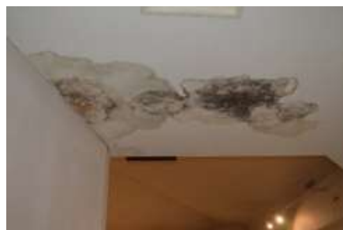
第73図 雨漏りによるシミ
