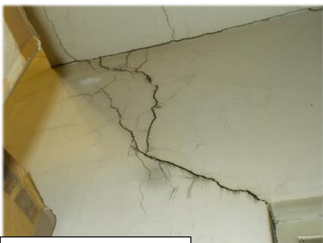
参考写真①（内壁ひび割れ）
